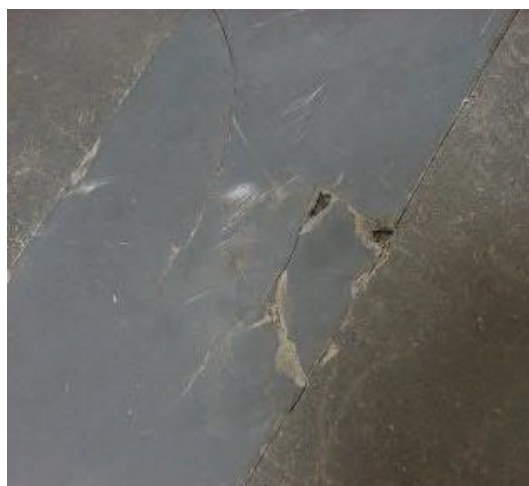
9. ábra: Az epoxi-gyantás javítás megrepedése
