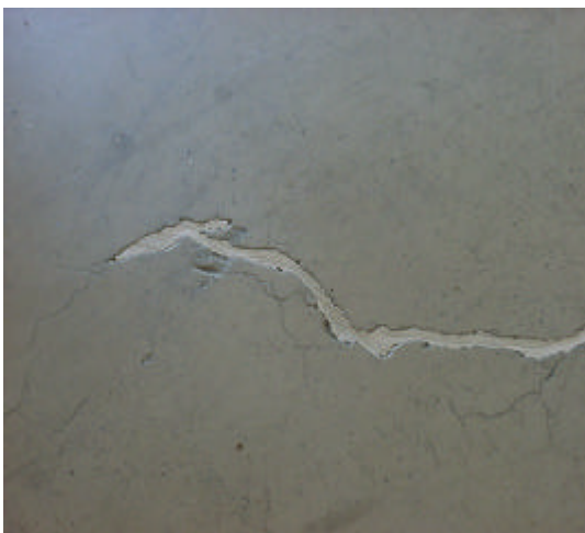
8. ábra: Epoxi-gyantával javított repedés
